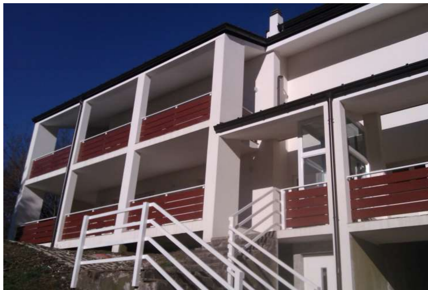
FOTO 3: VISTA DAL BASSO ZONA ELEVATORE PER DISABILI
