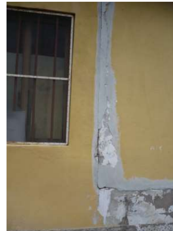
Foto 5: FESSURAZIONE SU MURATURA SACRESTIE
